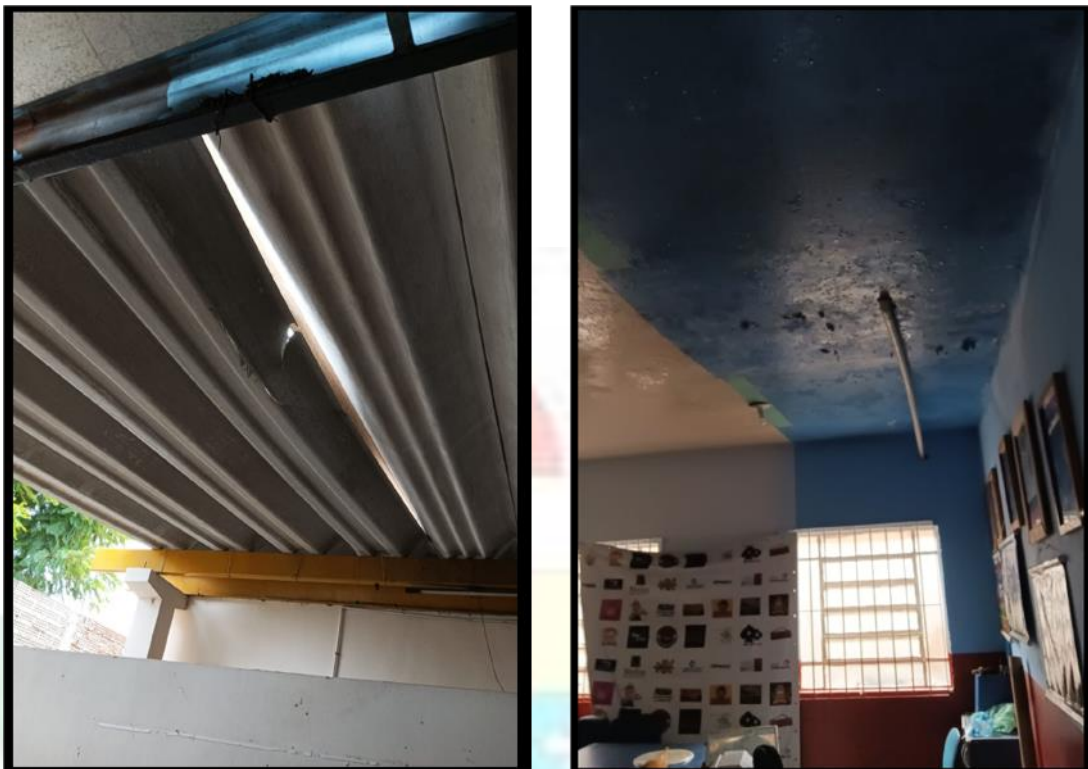
Figuras 3 e 4. Calhetão danificado visto por baixo e infiltração no teto do CRAS
