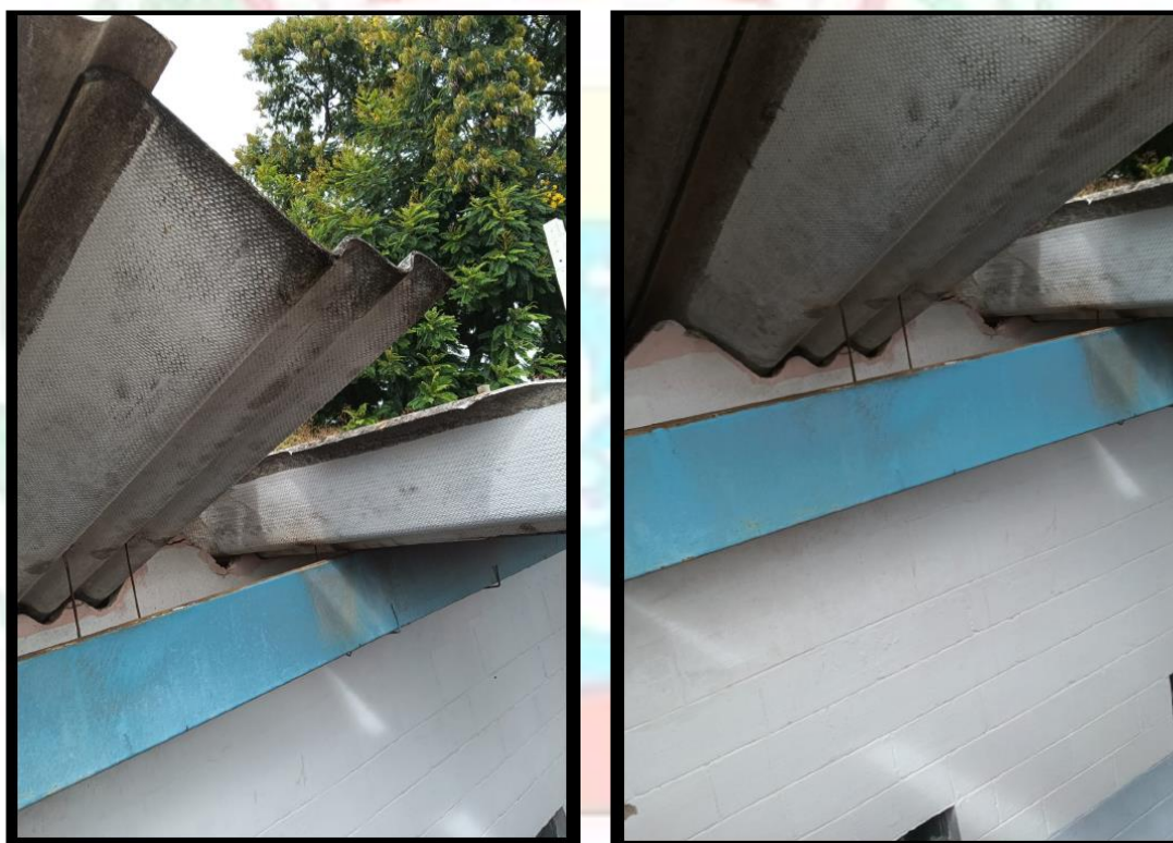
Figuras 1 e 2. Telhado com calhetões danificados
