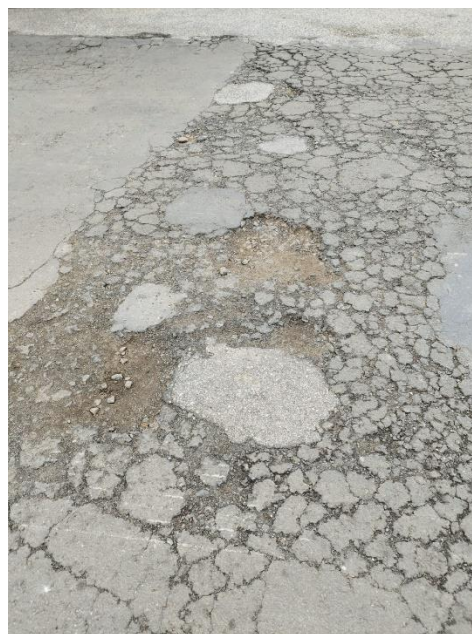
Figura 6. Rua Romênia. Trincas em malha ("couro de jacaré") e cavidades ("panelas")
