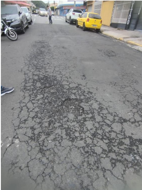
Figura 9. Rua Bulgária. Trincas em malha ("couro de jacaré")
