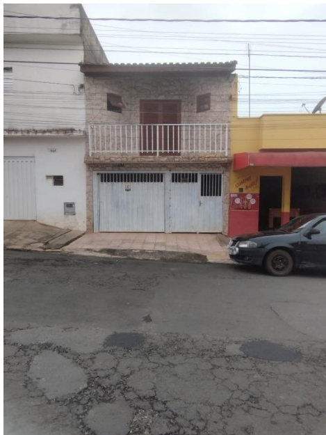
Figura 15. Rua Guatemala. Trincas em malha ("couro de jacaré").
