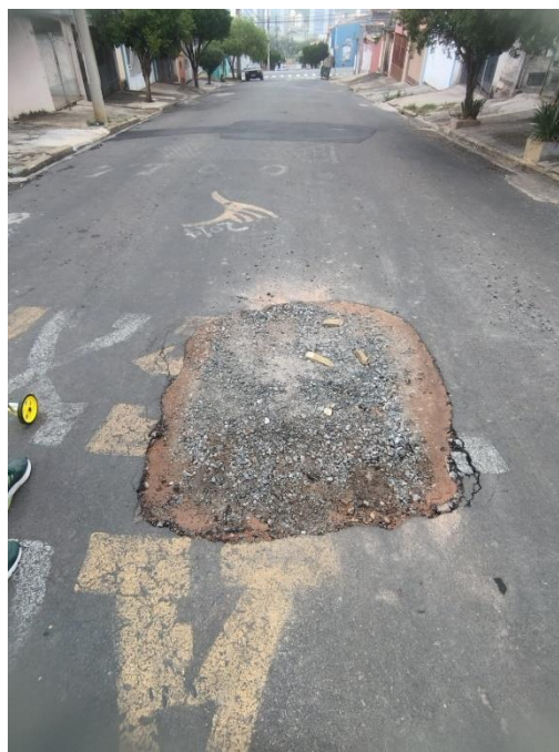
Figura 8. Rua Bulgária. Cavidade ("panela").
