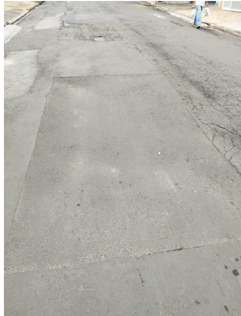
Figura 2. Rua Romênia. Afundamento de consolidação
