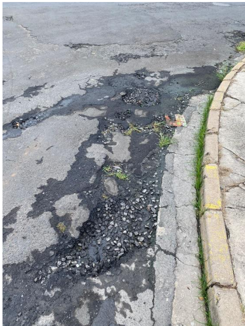
Figura 11. Rua Hungria. Cavidade ("panela") junto ao meio-fio.
