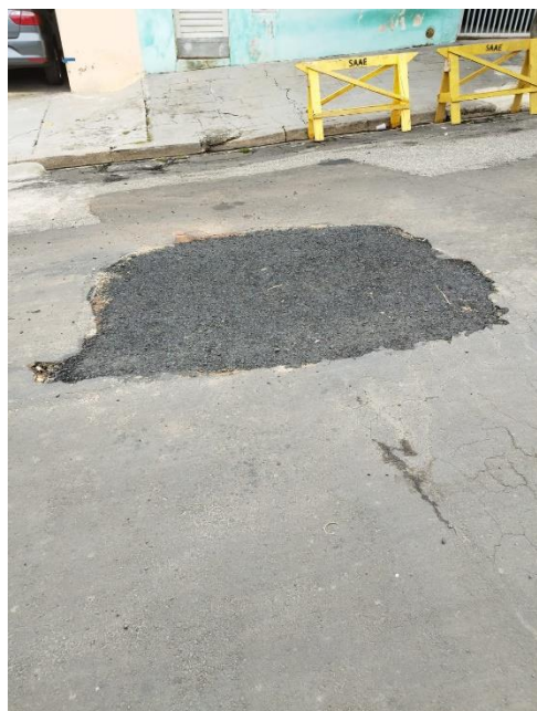
Figura 5. Rua Romênia. Remendo
