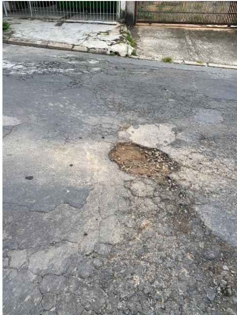
Figura 13. Rua Peru. Cavidade ("panela").
