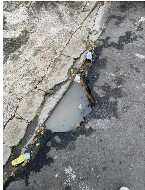
Figura 12. Rua Hungria. Cavidade ("panela") junto ao meio-fio.
