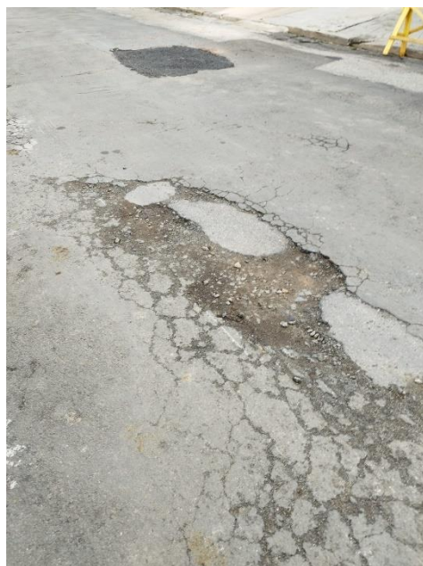
Figura 3. Rua Romênia. Cavidade ("panela")
