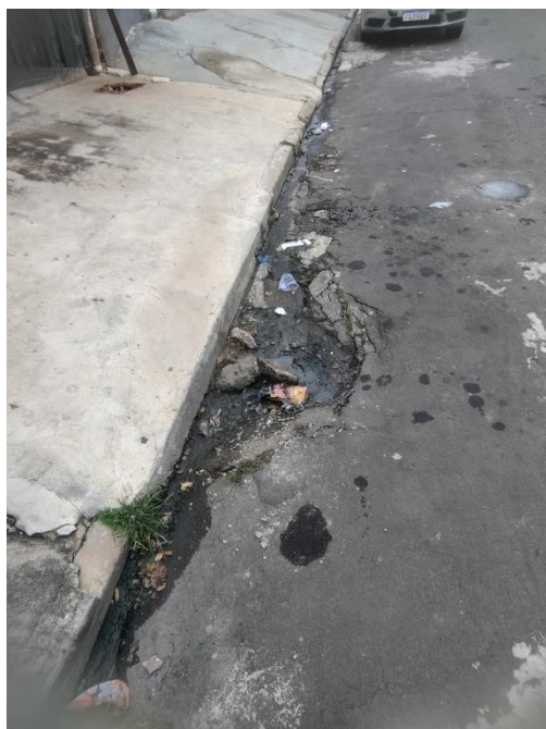
Figura 7. Rua Albânia. Cavidade ("panela") junto ao meio-fio.
