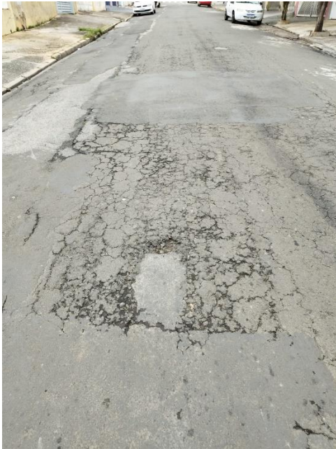
Figura 1. Rua Romênia. Trincas em malha ("couro de jacaré")
