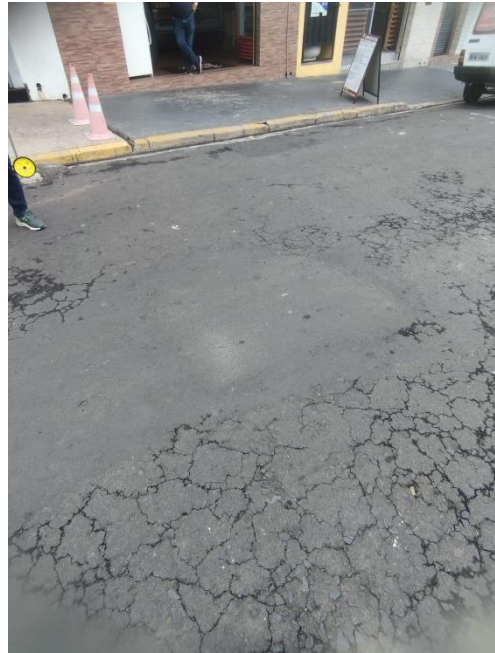
Figura 10. Rua Bulgária. Trincas em malha ("couro de jacaré")
