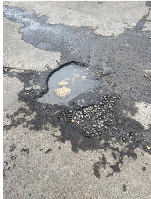
Figura 14. Rua Peru. Cavidade ("panela").
