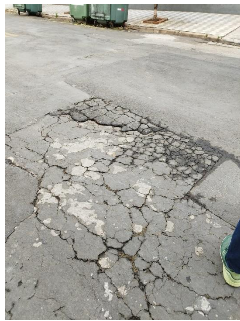
Figura 4. Rua Romênia. Trincas em malha ("couro de jacaré")
