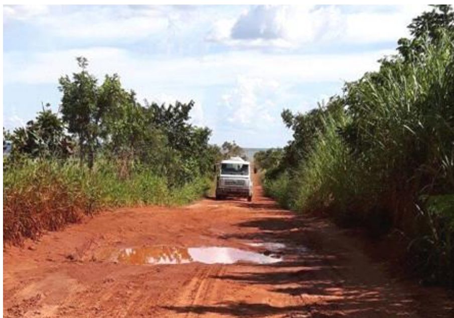
Figura 15 - Ponto crítico de empoçamento.
