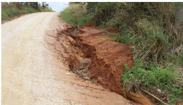
Figura 25 - Intensa erosão localizada na lateral na estrada SLT 413.
