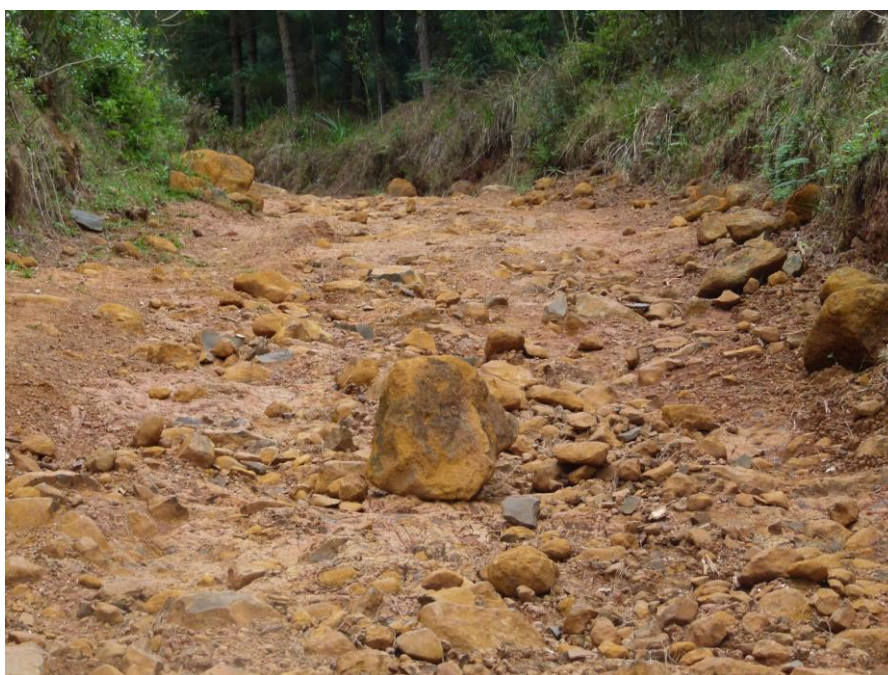
Figura 6 - Ponto crítico severo de afloramento de rocha.
