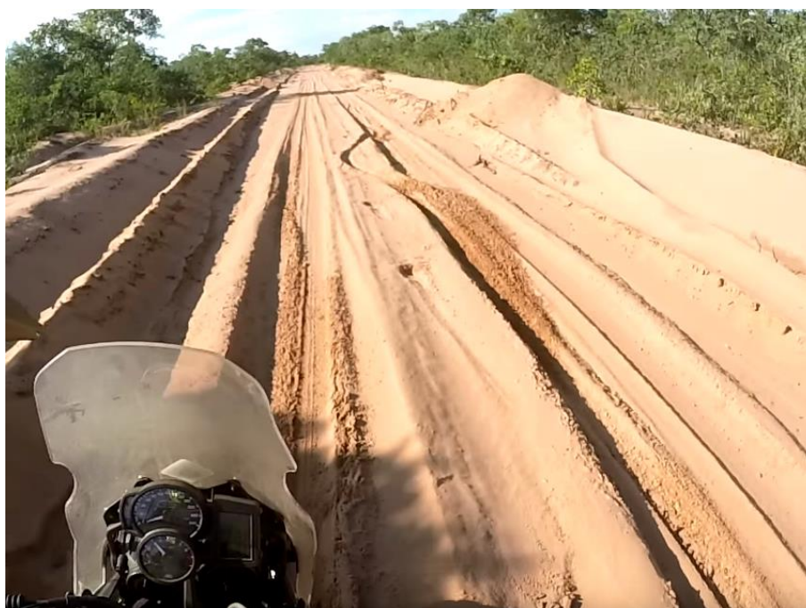
Figura 8 - Ponto crítico de areião severo.
