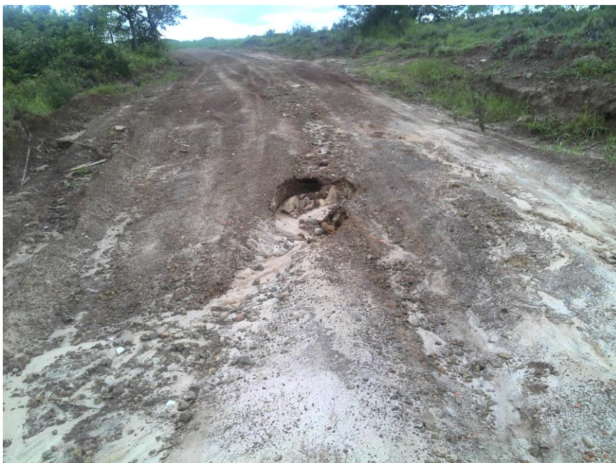
Figura 20 - Ponto crítico de erosão no leito carroçável da estrada.
