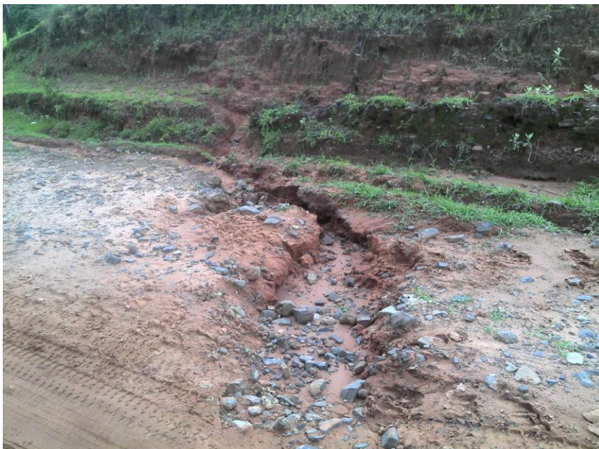
Figura 19 - Ponto crítico de erosão nas sarjetas da estrada.
