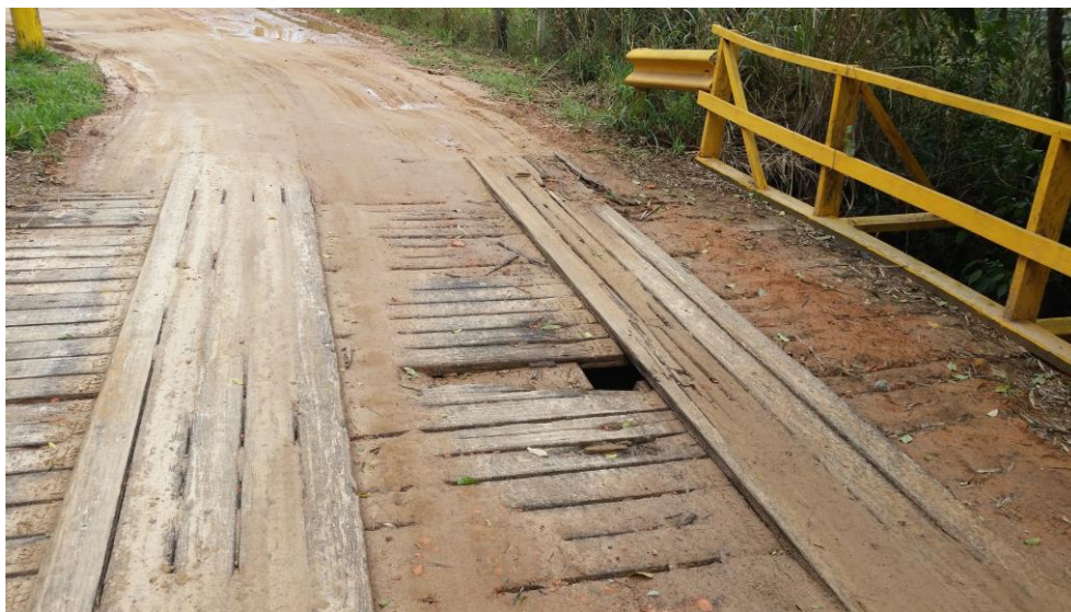
Figura 12 - Ponte de madeira com base metálica localizada na estrada SLT 249, a estrada apresenta pequenas avarias nas tábuas de madeira no leito carroçável.
