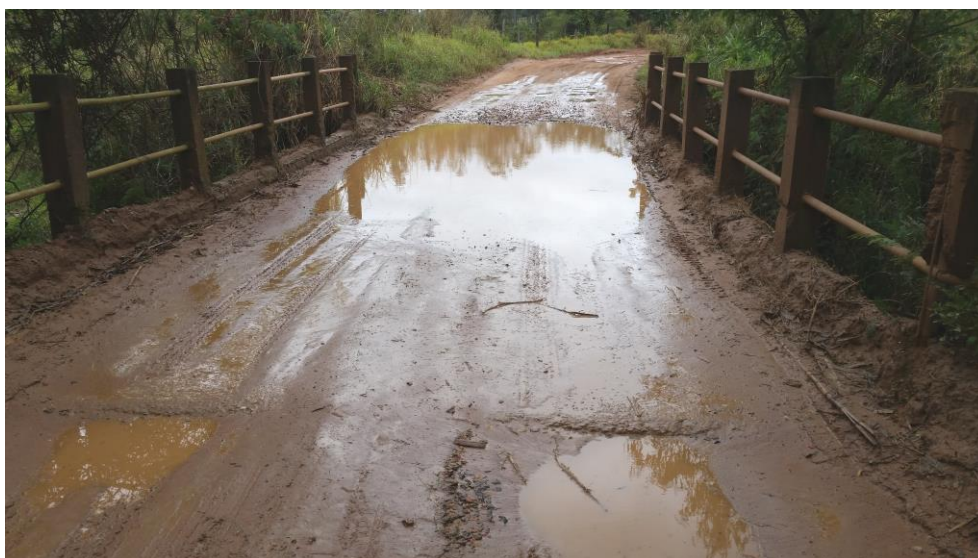
Figura 5 - Ponte de concreto com intenso empoçamento no leito carroçável localizada na estrada SLT 426.
