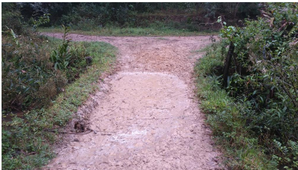
Figura 1 - Ponte de madeira localizada na estrada SLT 413, não possuindo qualquer indicação de segurança.
