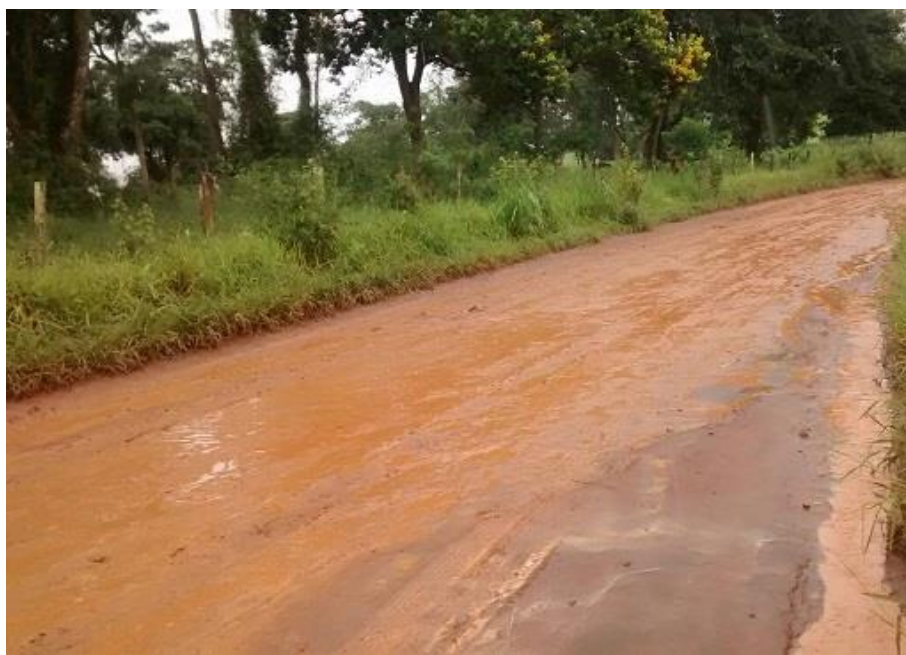
Figura 14 - Ponto crítico de pista escorregadia.
