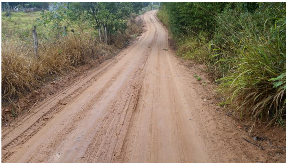
Figura 2 - Estrada SLT 413 onde se encontra uma imperceptível ponte de concreto, sem qualquer segurança na lateral direita.
