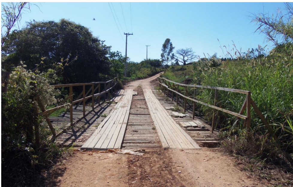
Figura 16 - Ponte de madeira encontrada na estrada Porto Góis, apresentando as devidas medidas de segurança.
