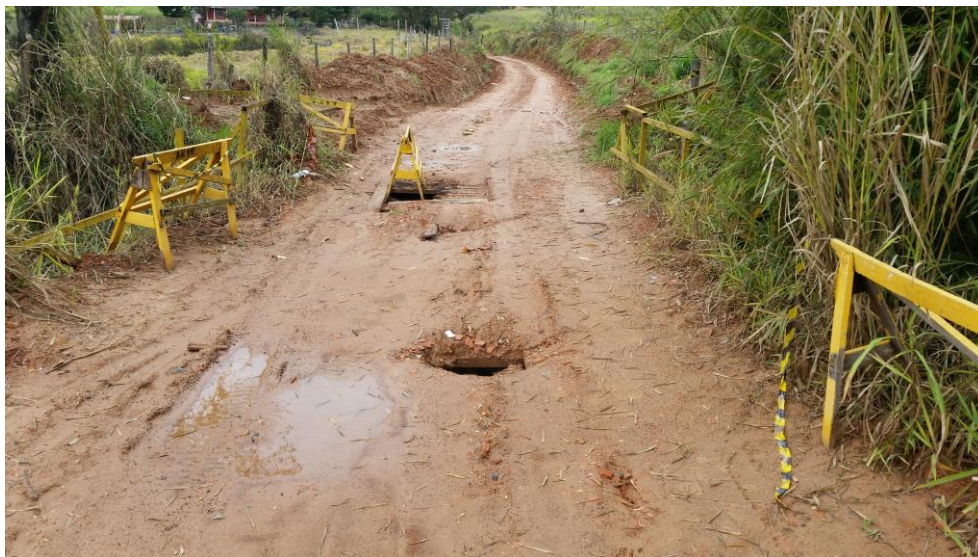
Figura 6 - Ponte de madeira com grandes avarias localizada na estrada concessionária da rodovia Tietê.
