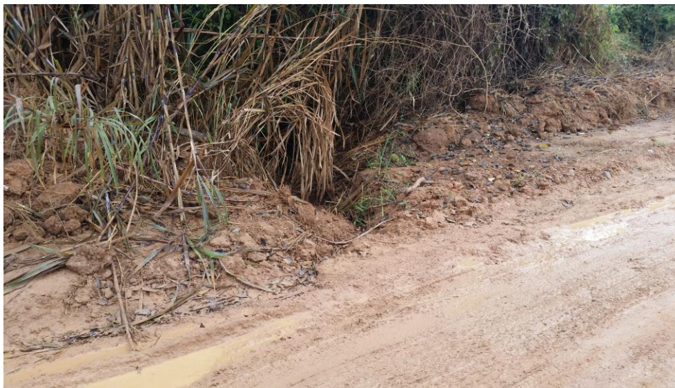
Figura 21 - Pequena erosão na lateral da estrada SLT 249.
