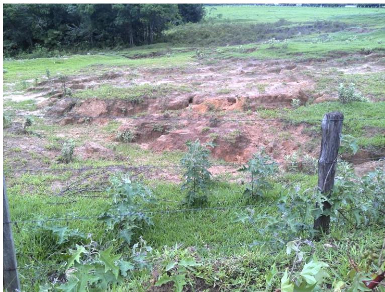
Figura 18 - Ponto crítico de erosão nas margens da estrada.
